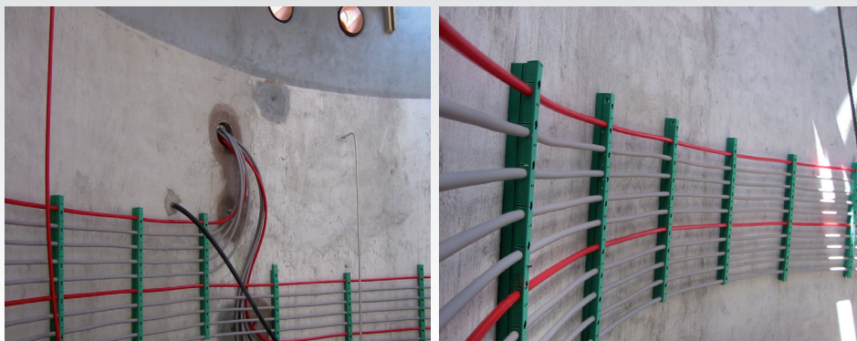
Figura 26: Sistemas de calefacción de digestores
