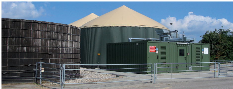
Figura 9: Planta de biogás
