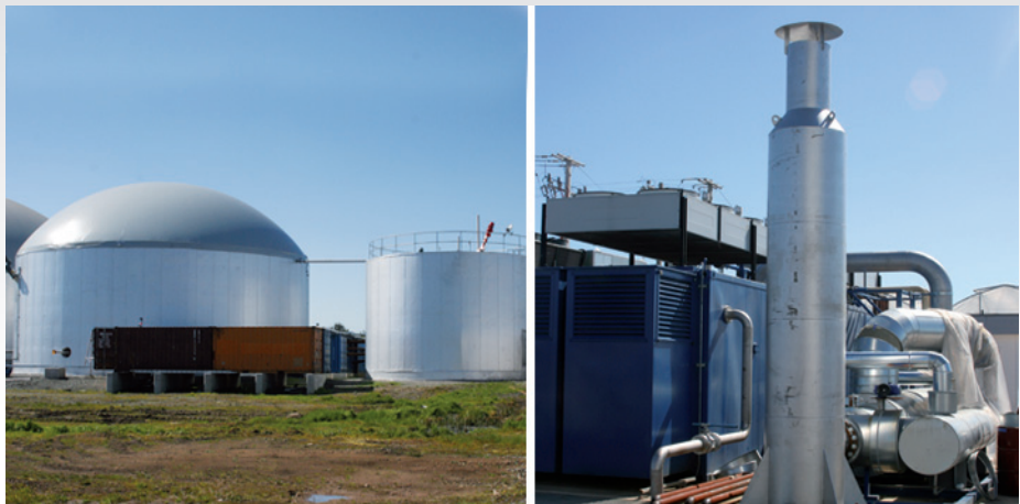
Fuente: Gentileza de HBS Energía S.A.
