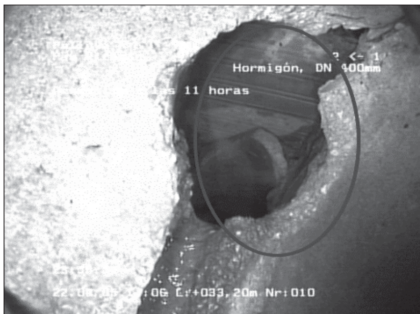
Figura 6.11. Agresión ácida a una acometida de aguas residuales industriales.
