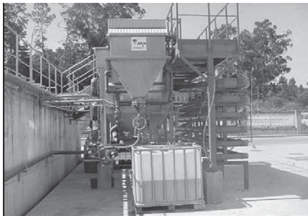
Figura 5.4. Vista general de una depuradora para efluentes de la elaboración de conservas de pescados .
