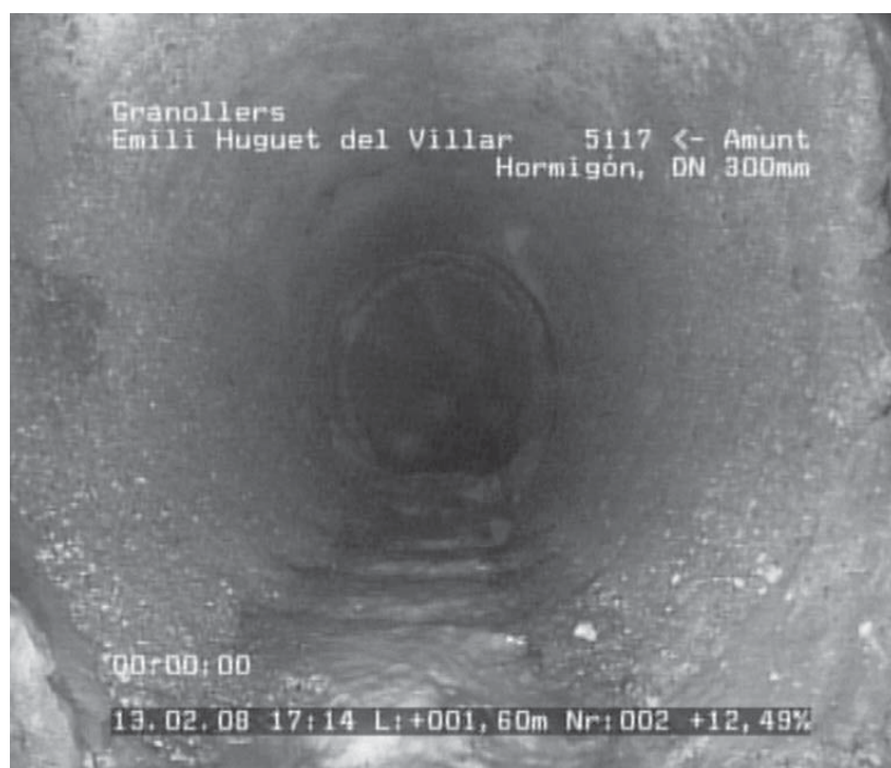
Figura 6.10. Acumulación de sólidos y fangos en colector de 300 mm.
