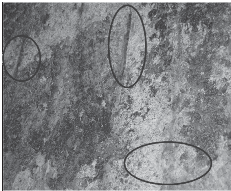
Figura 6.12. Pared de un emisario general de aguas residuales con muestras de corrosiones férricas.
