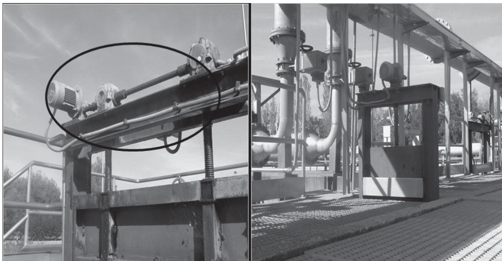
Figura 6.27. Comparación entre el estado de un elemento de una tajadera instalada en unas balsas de aireación, en material más inoxidable (derecha) o menos inoxidable (izquierda).
