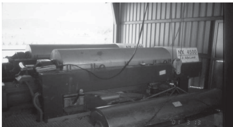
Figura 5.11. Vista de decantadores centrífugos para deshidratación de fangos procedentes de la depuración de aguas residuales urbanas.
