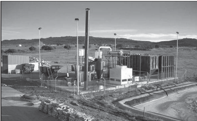
Figura 5.6. Planta depuradora de RSU instalada en el propio complejo de recogida y gestión de residuos sólidos urbanos.
