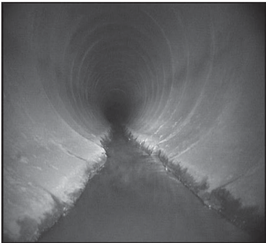
Figura 6.8. Aspecto degradado de colector de hormigón de 1.000 mm.
