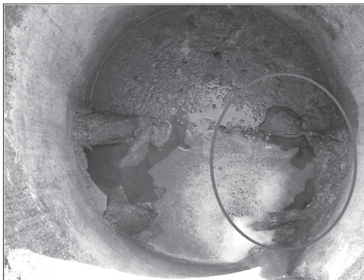
Figura 6.14. Corrosión ácida en un colector de pequeño diámetro.
