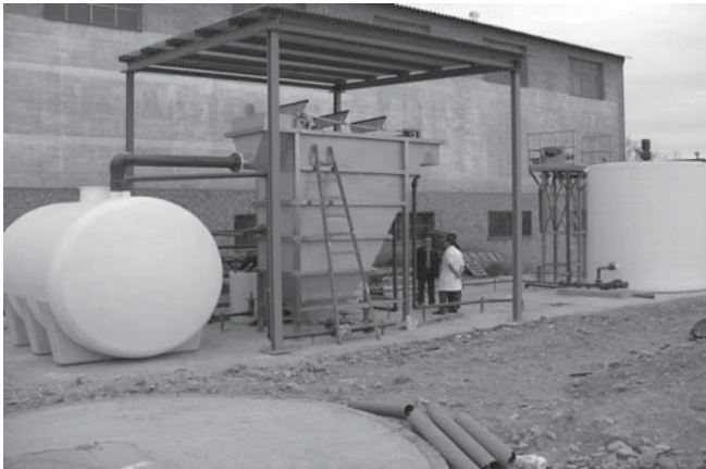
Figura 5.1. Sistema de depuración para efluentes de fabricación de mayonesas y salsas alimentarias preparadas ( línea de proceso de derecha a izquierda ).
