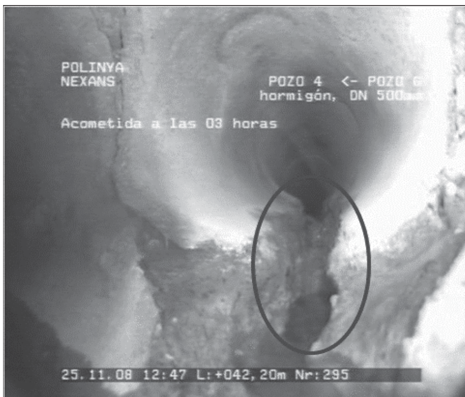
Figura 6.7. Deterioro en la acometida a un colector de hormigón de 500 mm de diámetro.
