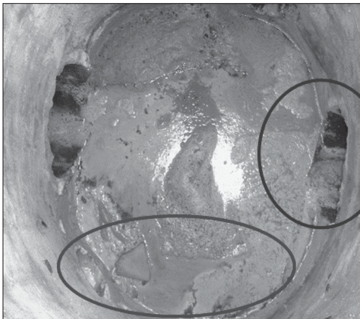
Figura 6.15. Efectos de agresión ácida y corrosión electroquímica.
