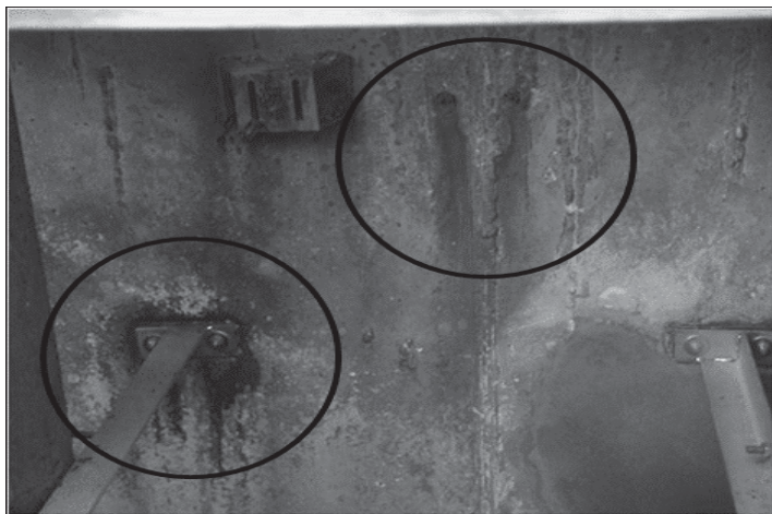
Figura 6.22. Corrosión externa en pared de un decantador primario.
