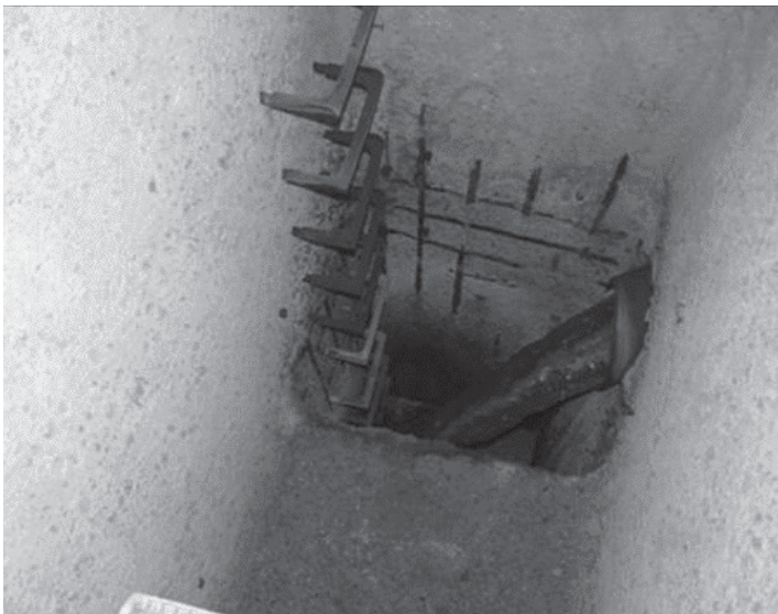
Figura 6.25. Aspecto del pozo de recogida de aguas de lixiviado de un espesador de fangos.
