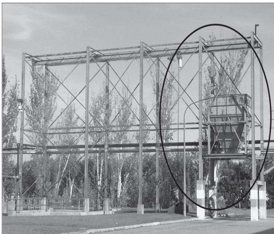
Figura 6.19. Corrosión del puente metálico de recogida de gruesos de una EDAR.
